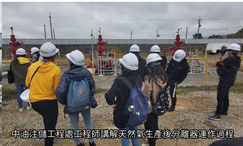
中油注儲工程處工程師講解天然氣注入與生產井井頭設施
